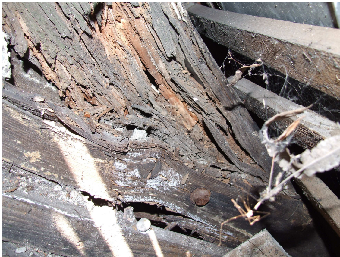
Vista della struttura del tetto ammalorata
