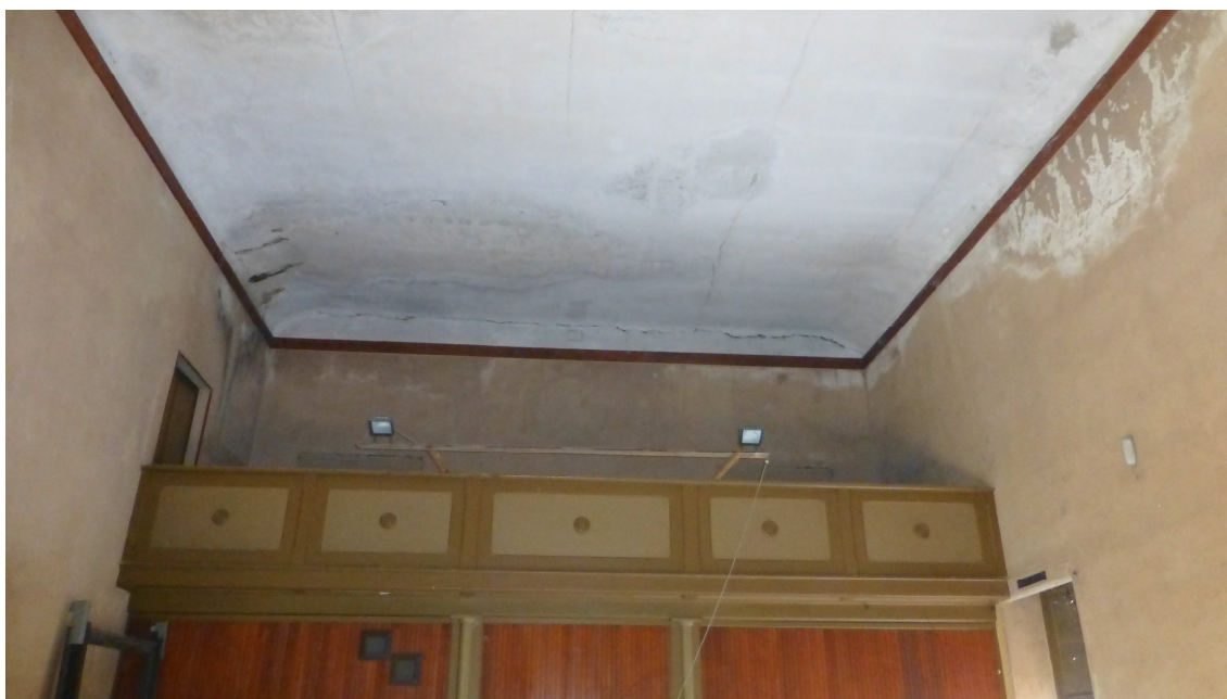
Vista del controsoffitto ammalorato
