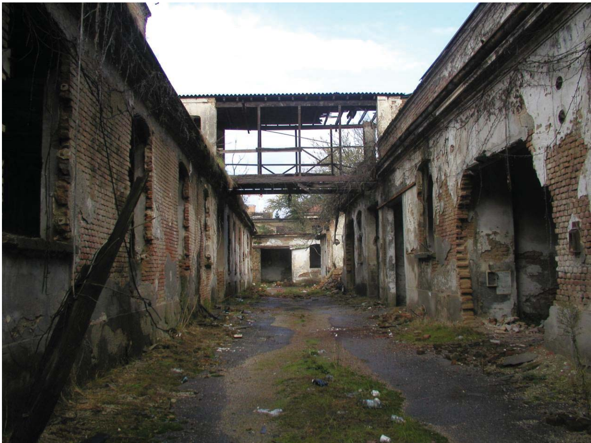
Foto 2: corridoio nord sud di ingresso all'area, tra gli edifici orientali, parzialmente demoliti o crollati
