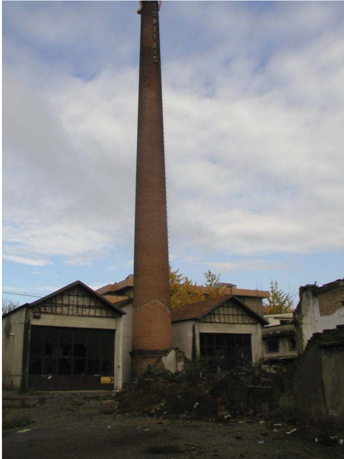
Foto 8: uno dei capannoni recenti e in buono stato di conservazione lungo il perimetro nord del sito e la ciminiera.
