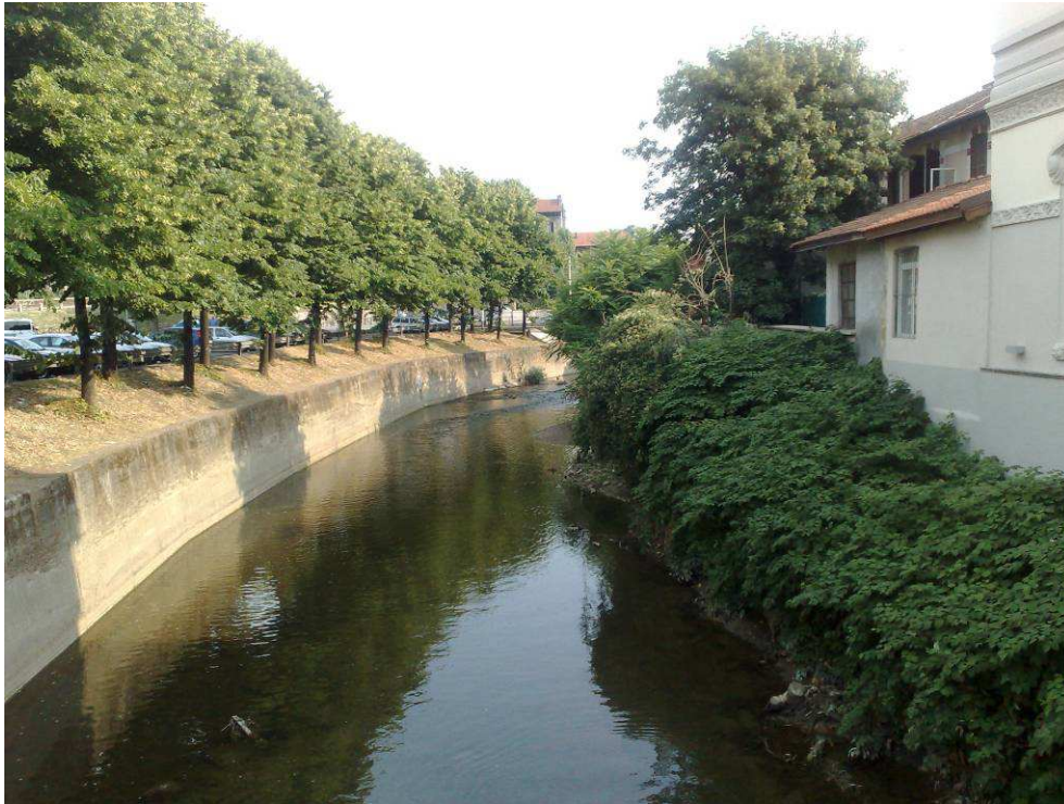
Figura 7.4.1 - Scabrezze ridotte nel tratto a monte del ponte di Via Mentana per la presenza di una sponda in c.a..
