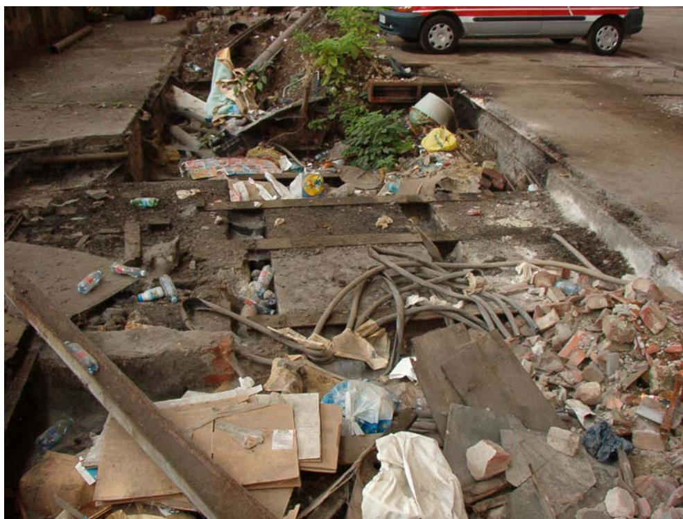
Foto 8 – vano alloggiamento macchinario
