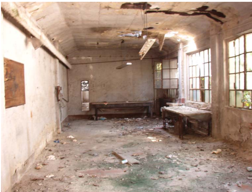
Foto 12 – sala prova processi filtrazione
