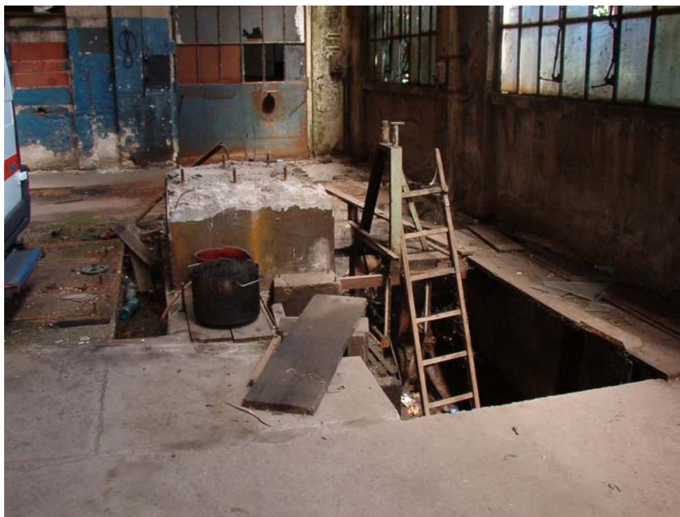
Foto 9 – vano alloggiamento macchinario
