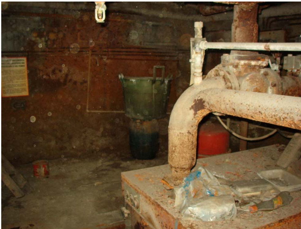
Foto 7 – ex fabbricato sede produttiva: locale caldaia interrato
