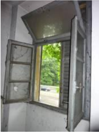
Degradato dei serramenti
