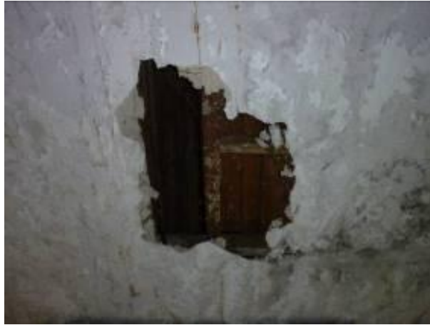
Cedimento porzione di controsoffitto
