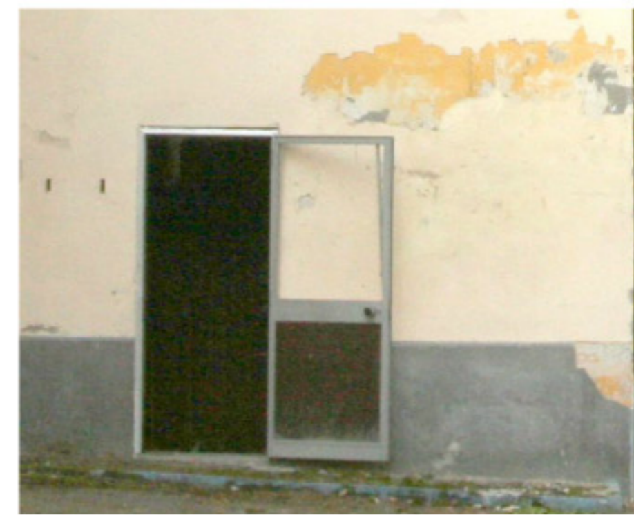
Particolare della zoccolatura realizzata con malta di cemento, ricoperta con intonachino plastico tipo terranova molto degradato. La presenza massiccia di cemento favorisce anche la migrazione dei sali e la cristallizzazione interna con la creazione di distacchi nell'intonaco.
