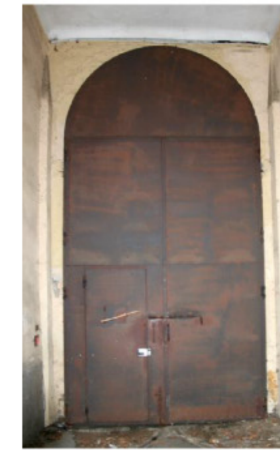
Particolare del portone di ingresso in legno rivestito con lastre di ferro. La mancanza di un'adeguata protezione superficiale ha favorito un'ossidazione abbondante su telaio e pannelli.
