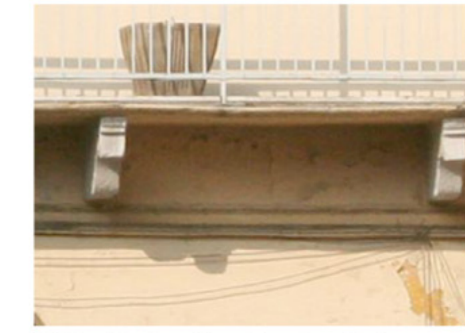
Particolare dei reggimensola in granito a sostegno del balcone. Si evidenzia la mancanza di porzioni, deposito superficiale di polveri e sporco generalizzato, con colate di ruggine, e verniciature che non permettono con certezza di identificare lo stato della pietra sottostante.
