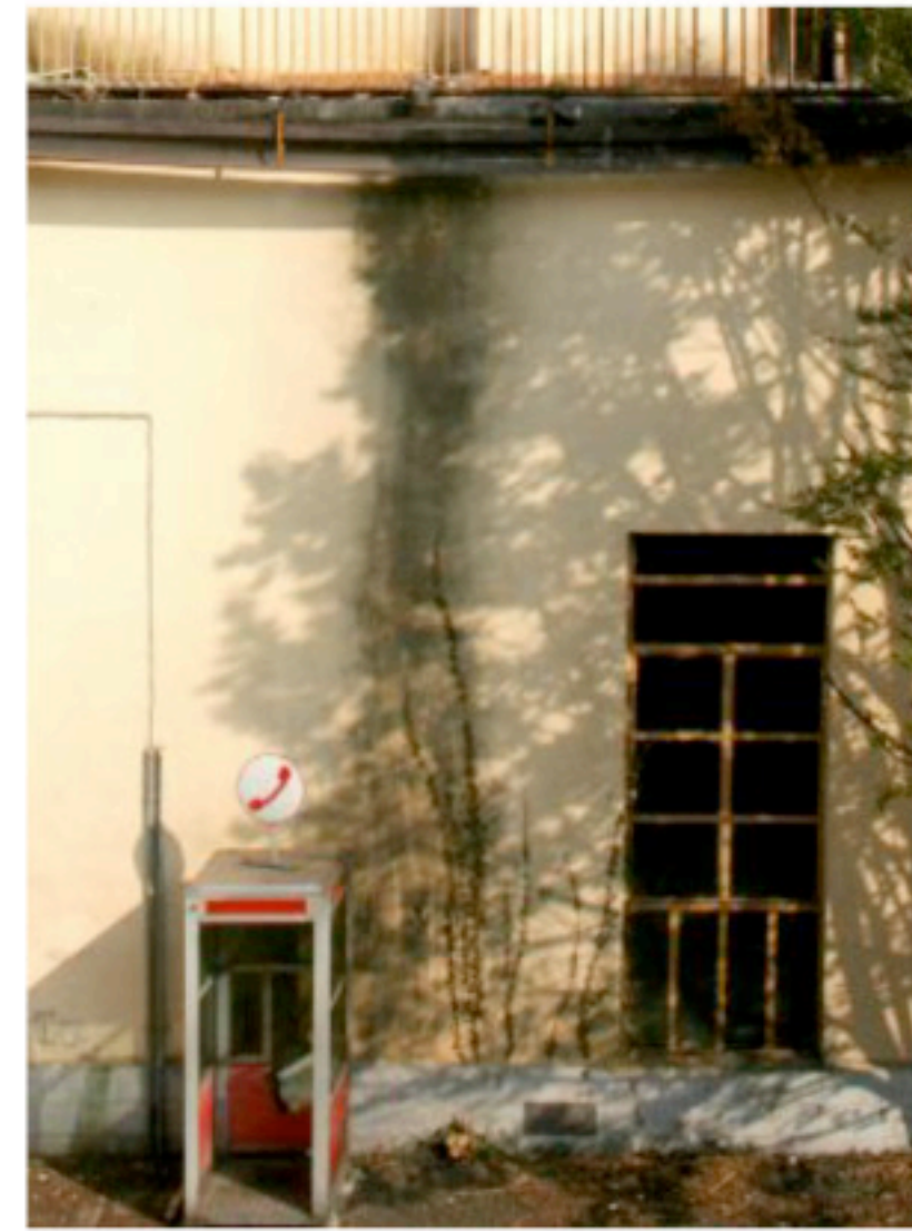
Particolari della facciata in corrispondenza del pluviale interno alla muratura. La presenza di acqua del pluviale ha comportato, il degrado dell'intonaco di facciata, con la formazione di una patina dovuta all'azione di alghe e licheni.
