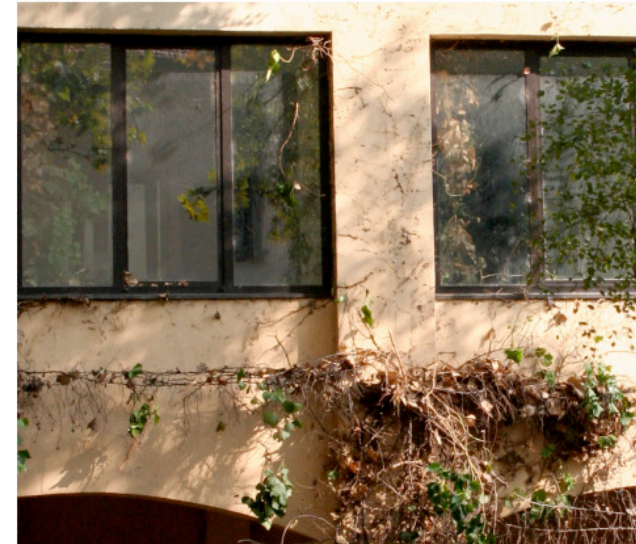
Particolare della facciata con presenza di vegetazione. Le radici della vegetazione, hanno provocato il degrado superficiale dell'intonaco
