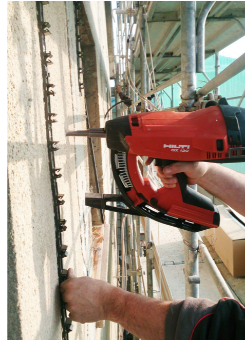
2. Fissaggio guide per alloggiamento circuiti idraulici seguendo il passo previsto in progetto
